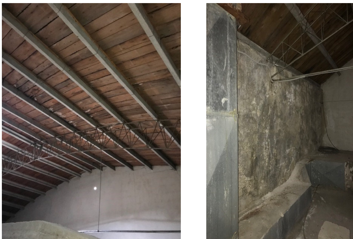
Particolare interno delle coperture con evidente stato di degrado
